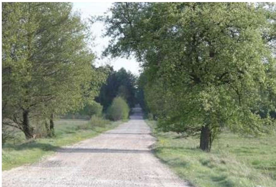
Przykład drogi na Zbójno wymagającej generalnego remontu.
